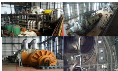
Slika 3. Prikaz složenih i kompleksnih kotlovskih i turbinskih postrojenja
